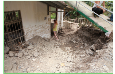
Ngoài nhà bị ảnh hưởng vì nạn sạt lở đất
