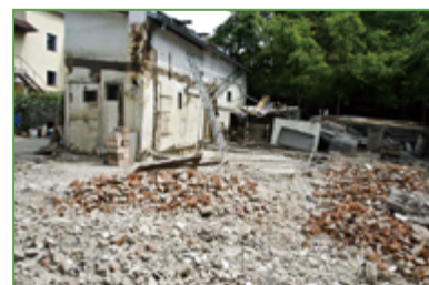
Một số công trình kiến trúc đã bị san bằng.
