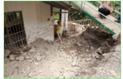
Ngoại nhà bị ảnh hưởng vì nạn sạt lở đất
