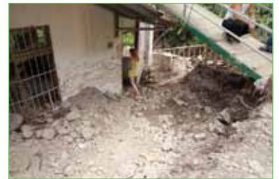
土石流沖入民宅
