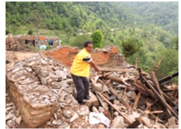
在德拉卡區的居顧村（Jugu）清理倒塌的房子
